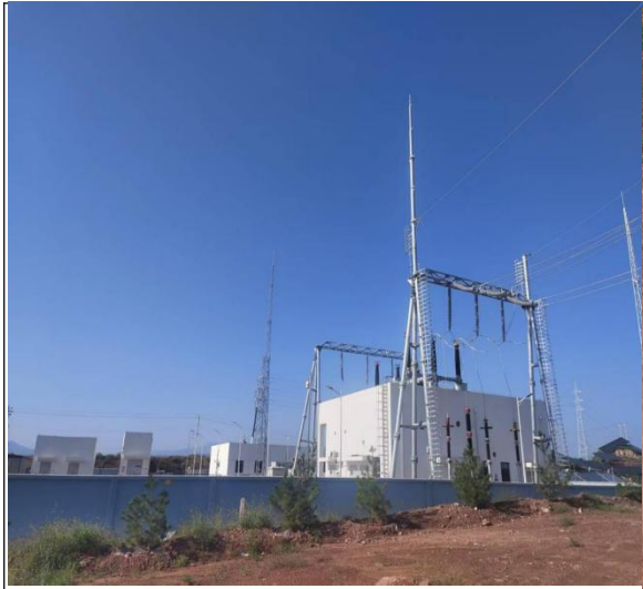
光伏发电项目升压站
