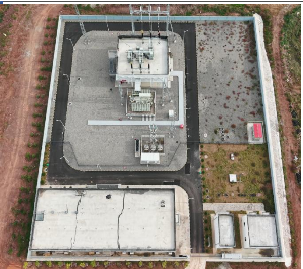
光伏发电项目升压站
